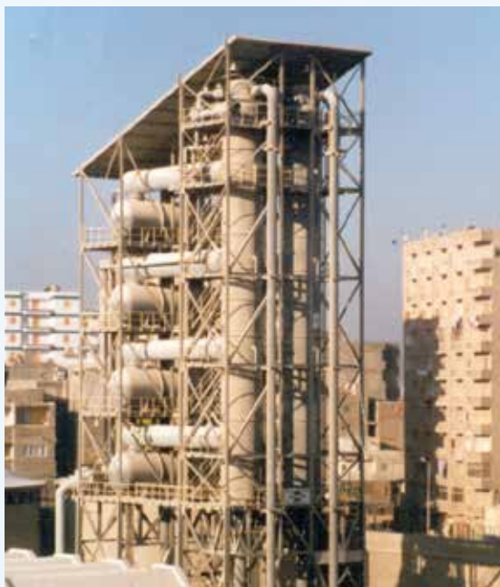
埃及的蒸汽喷射制冷单元，28 MW，流量 1 600 m 3 /h，由 35 °C 到 20 °C
