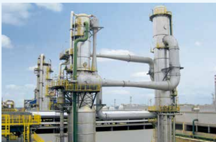
中国石油四川蒸汽喷射制冷单元，24 MW，流量 2 300 m 3 /h，由 29 °C 到 20 °C
