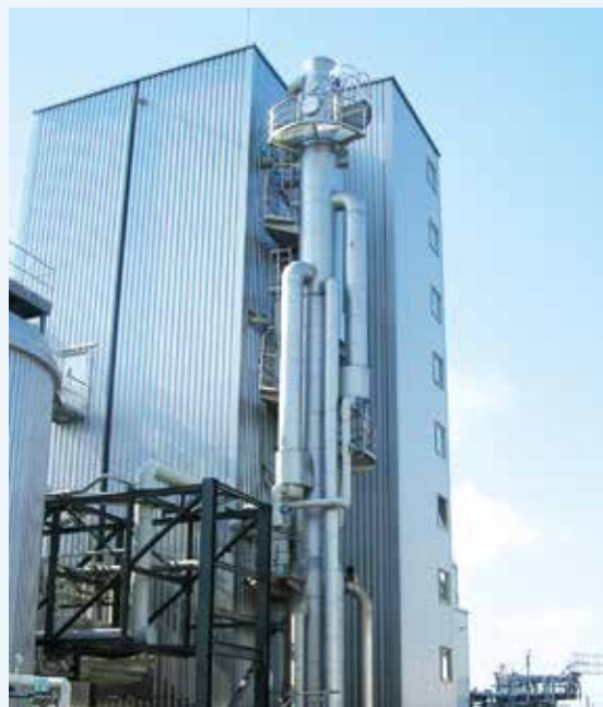
在施滕达尔的蒸汽喷射制冷单元，1.4 MW，流量 72 m 3 /h，由 25 °C 到 8 °C
