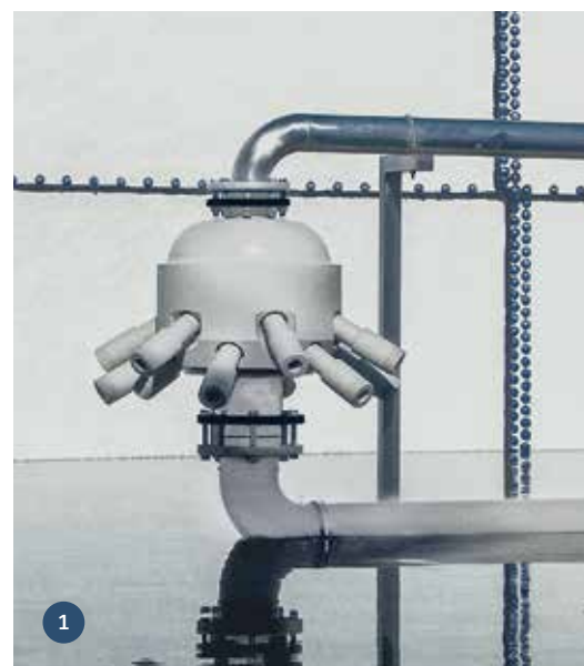
2) 曝气池外部安装的穿墙式射流器
