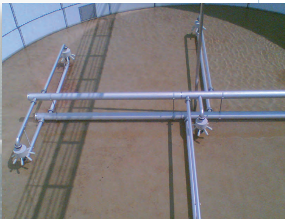
在 2 000 m 3 曝气池内安装的 7 路射流器
